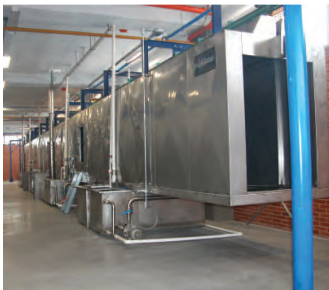
Tanques de limpieza - Planta de Pintura
